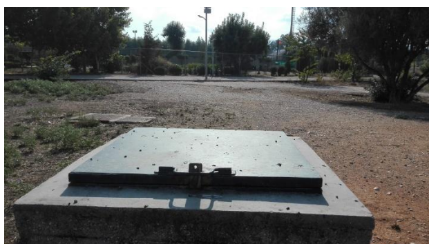
Εικόνα 22: Φρεάτιο Φ στην έκτη λίμνη, νότια του Πάρκου.
